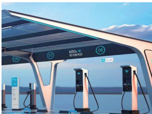
电动汽车快充电站
